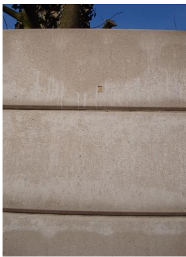
Aspect après nettoyage à l'eau haute pression, quelques jours après traitement
